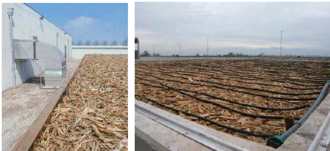
Рисунок 2.4.4 – Вид биофильтра с открытой поверхностью и системой увлажнения
